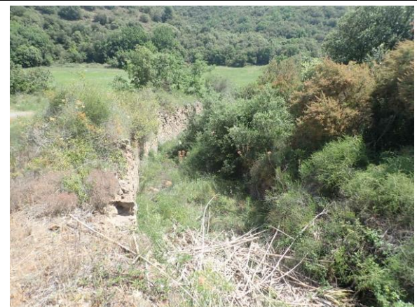
Illustration 36 : Canal d'évacuation de l'Hort-Estiou encombré par la végétation
