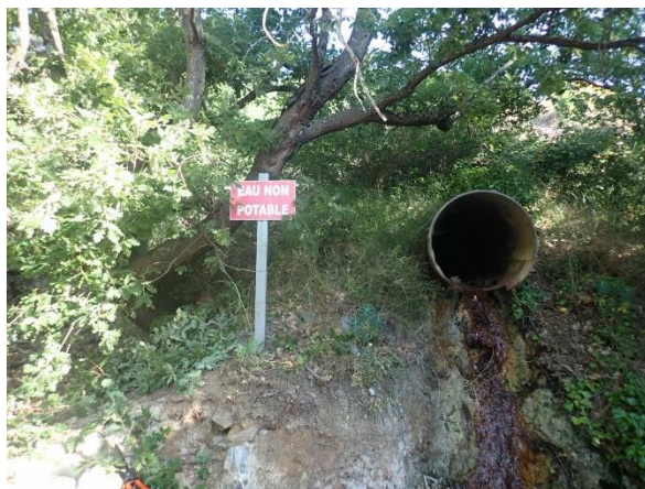
Illustration 39 : Panneau avertisseur au droit de la canalisation, désencombré
