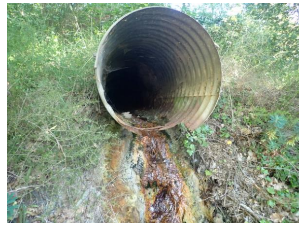
Illustration 40 : Canalisation corrodée, précipités ferrugineux en partie basse
