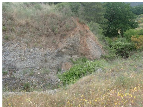
Illustration 35 : Ravinement prononcé en partie sommitale de la verse, au droit de l'ancien fontis
